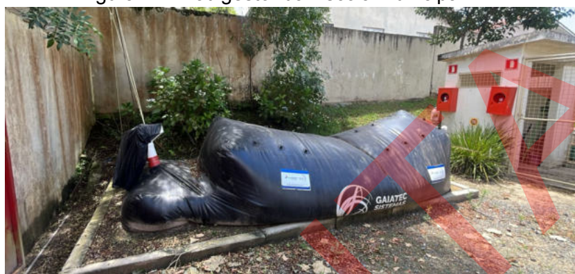
Figura 44: Biodigestor da Escola Municipal.
