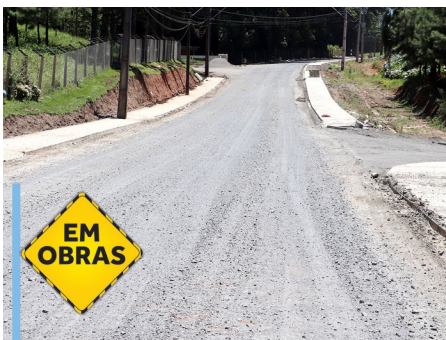
Trecho 01 da ligação Ponte Alta/Campina dos Crespins. Pavimentação de 1km. Investimentos de R$ 1.460.712,79.
